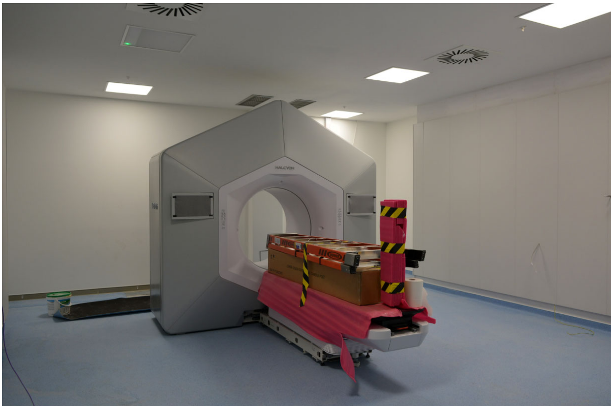
A HALCYON besugárzó összeszerelve a bunkerben.
